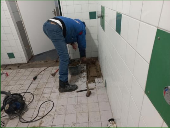
Lekkage waterleiding bestaande kleedkamers 1-6
