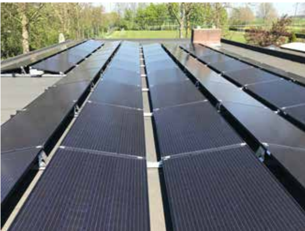
Zonnepanelen op het dak van de kantine
